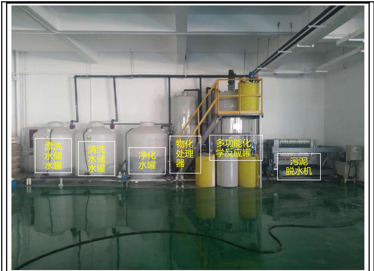
图 6 污水处理设备现状照片
