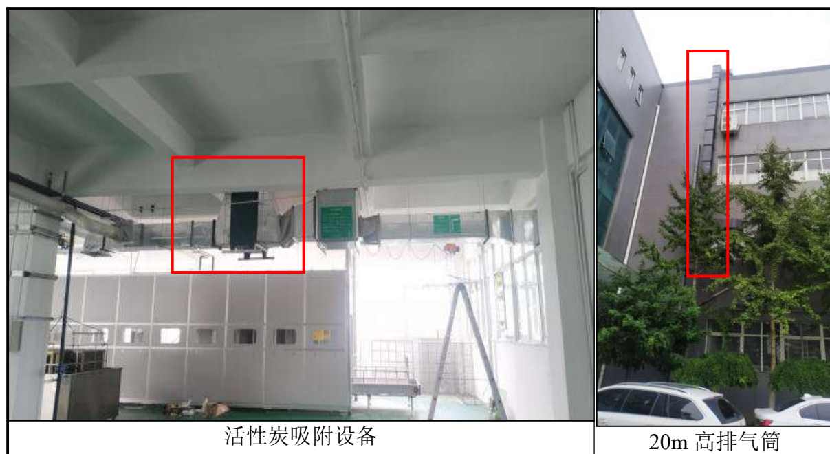
图4 废气处理设施现状照片
